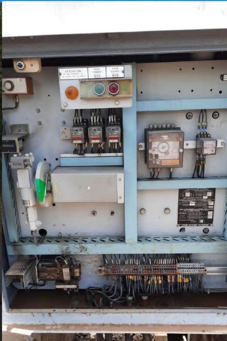
Les eaux sont montées en dessous du bornier
